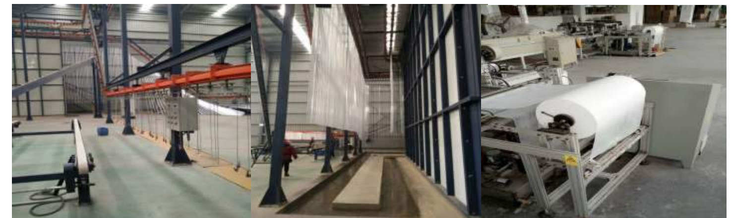
XƯỞNG SƠN HOÀN THIỆN
